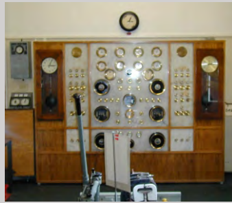
Uhrenzentrale der BVG bis 1970 in Betrieb
